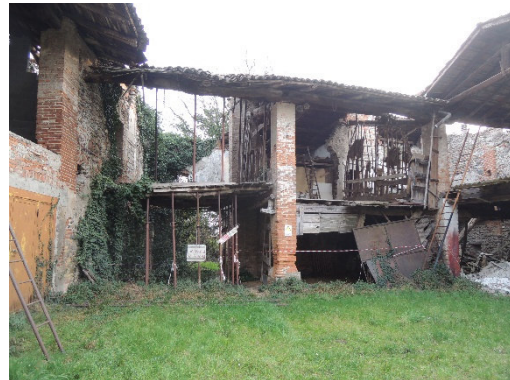
porzione di fabbricato in condizioni di degrado e "collassato"
