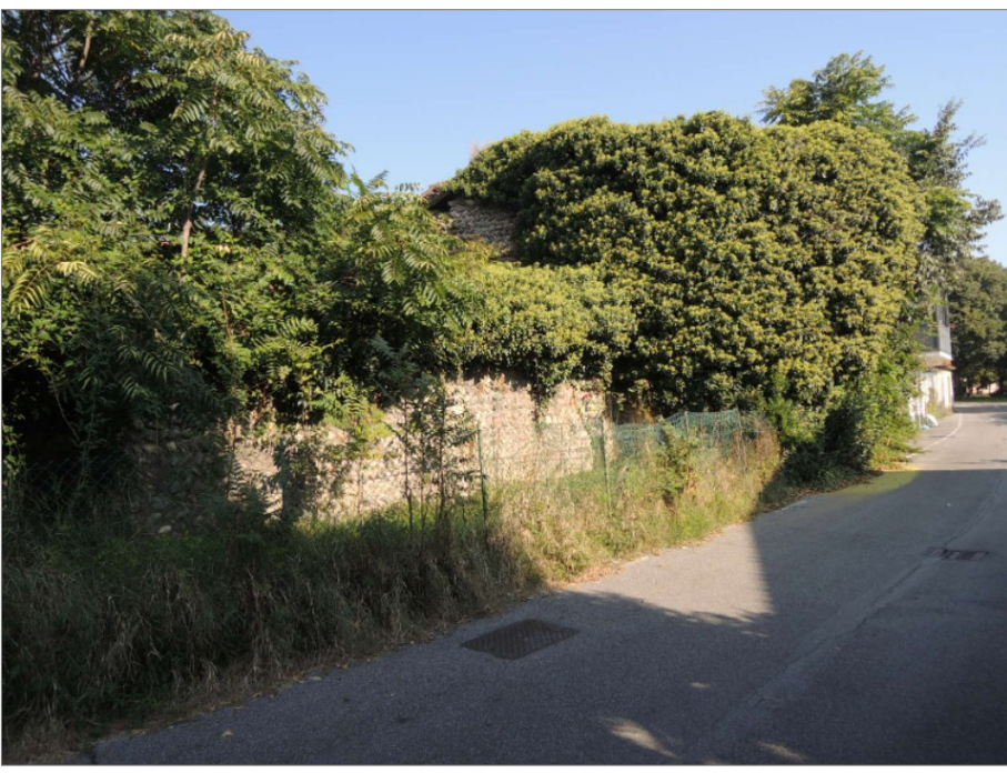
O torrione rotondo realizzato con ciottoli di fiume disposti a lisca di pesce, ricoperto dalla vegetazione e con copertura parzialmente crollata
