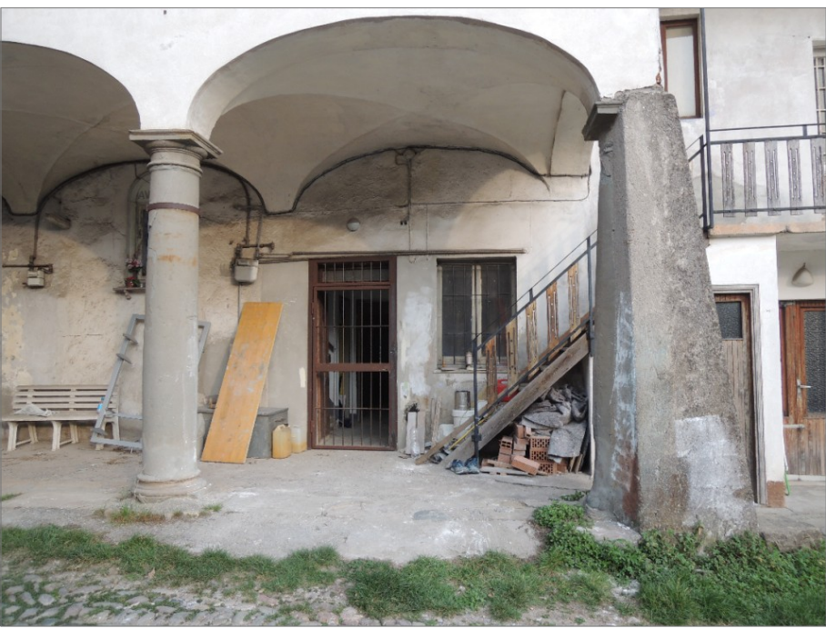
08\COLONNA IN CEMENTO - incongruenza materica
