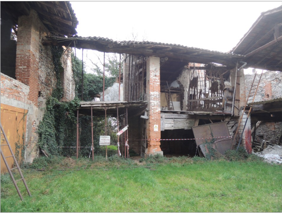
F porzione di fabbricato in condizioni di degrado e "collassato"
