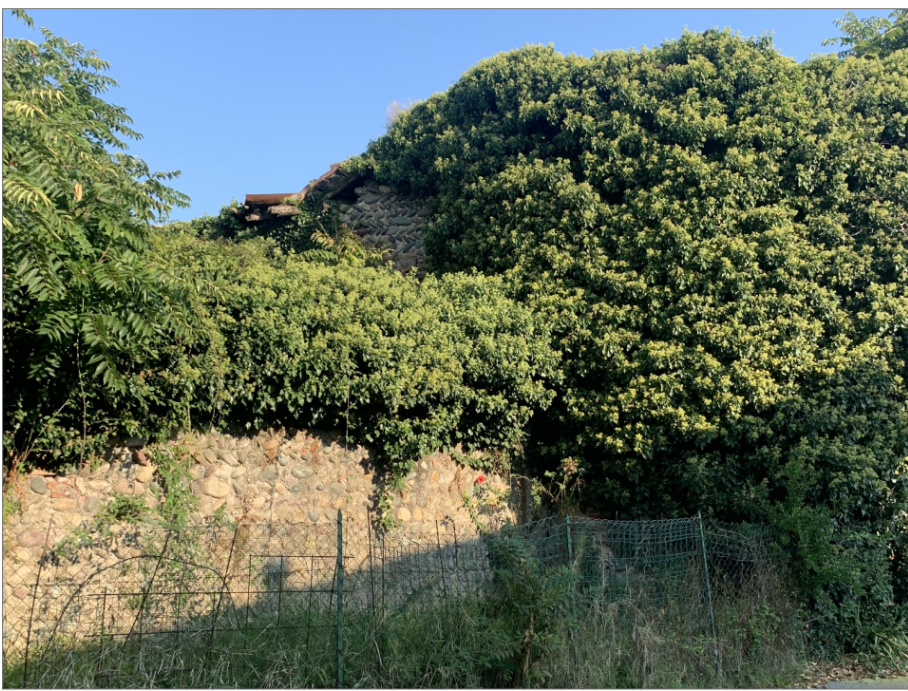
05\MURATURA PERIMETRALE e TORRIONE ROTONDO - cedimento strutturale; - presenza di vegetazione
