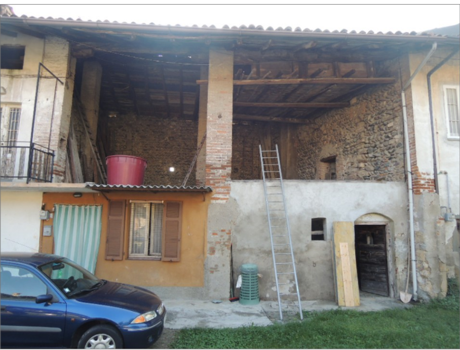
09\COPERTURA IN ORDITURA IN LEGNO E MANTO IN COPPI - degrado materico; - cedimento strutturale
