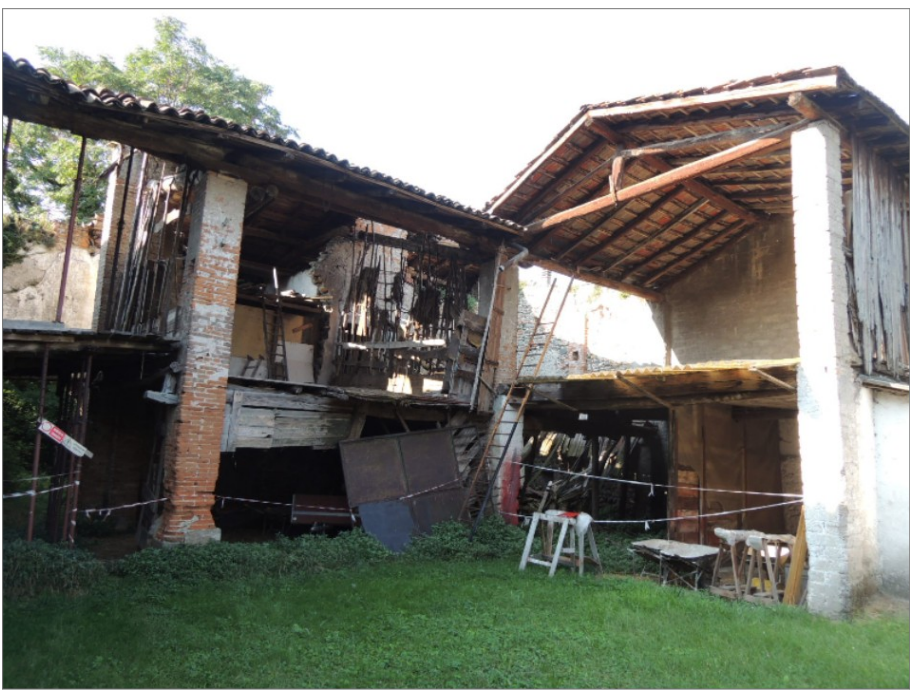
10\EDIFICIO DESTINAZIONE AGRICOLA - stato di degrado avanzato e struttura crollata
