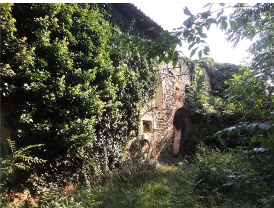
04\EDIFICIO DESTINAZIONE AGRICOLA - degrado materico: distacco e caduta di parti materiche; - cedimento strutturale
