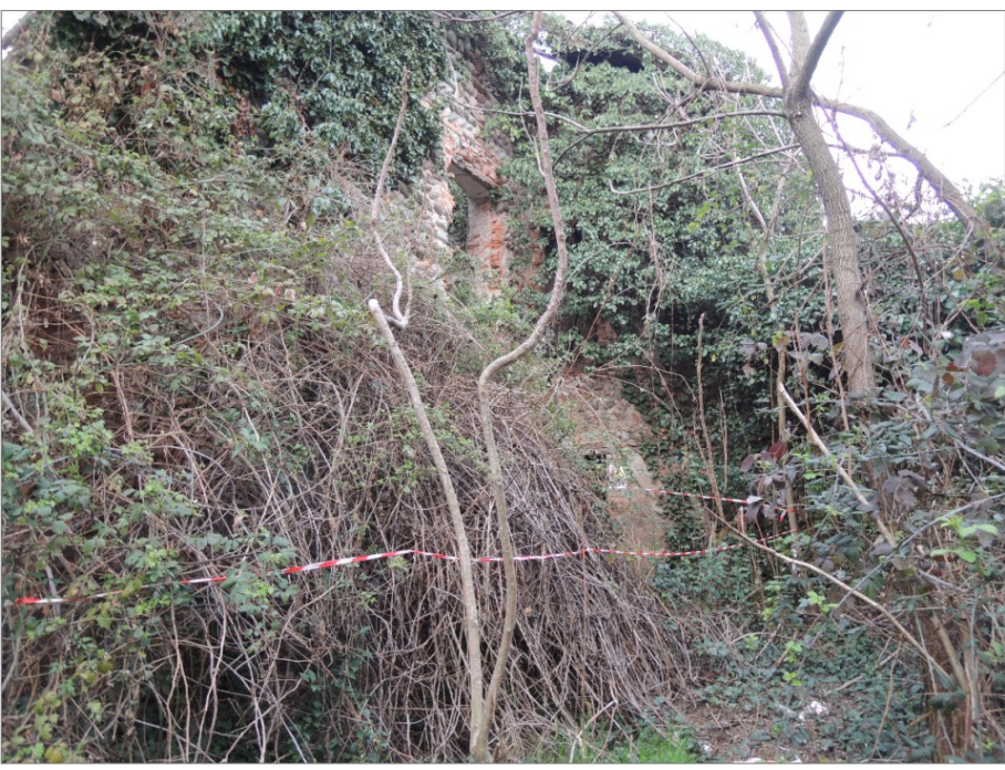
M torrione rotondo realizzato con ciottoli di fiume disposti a lisca di pesce, ricoperto dalla vegetazione e con copertura parzialmente crollata
