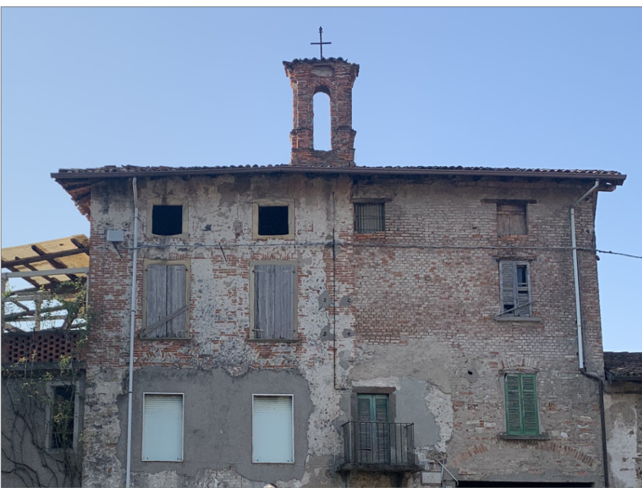
02\EDIFICIO INGRESSO FRONTE STRADA VIA GARIBALDI - degrado materico: distacco e caduta di parti materiche in facciata; - disomogeneità materica
