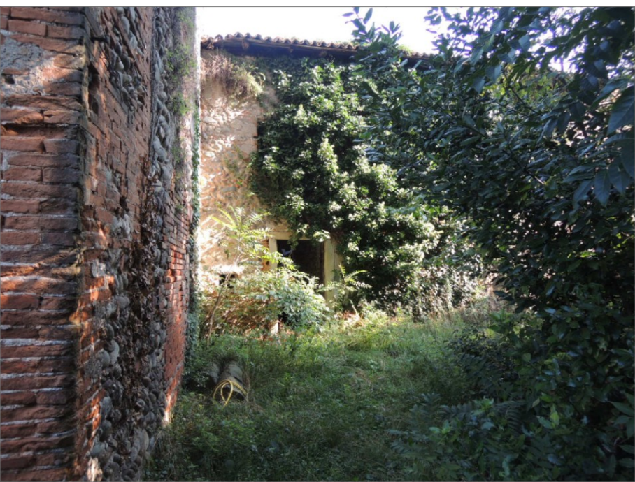
03\EDIFICIO DESTINAZIONE AGRICOLA - degrado materico: distacco e caduta di parti materiche; - cedimento strutturale
