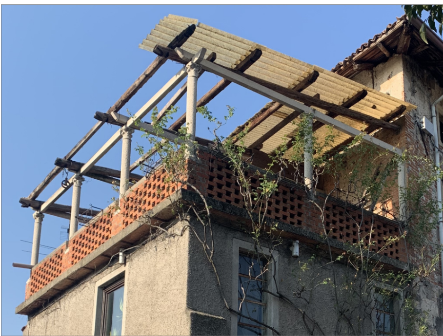
01\TERRAZZO SOPRSTANTE EDIFICIO RELIGIOSO - incongruenza materica rispetto al complesso edilizio; - disomogeneità materica; - realizzazione postuma
