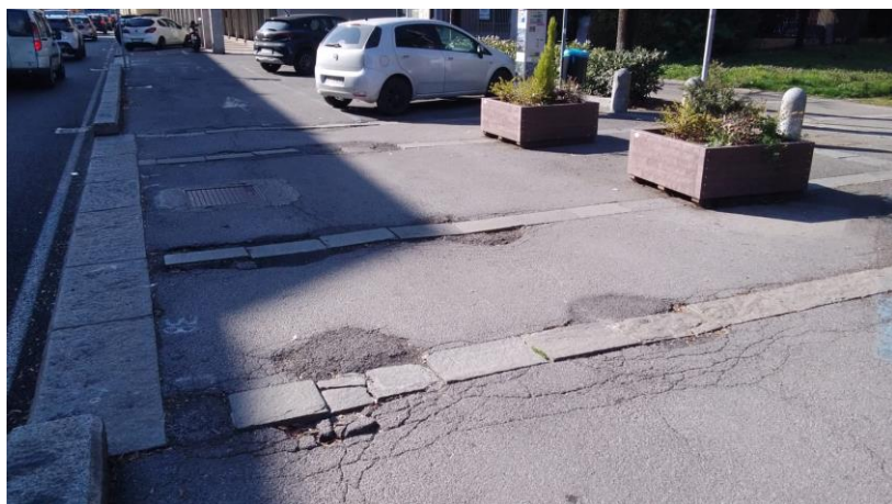
Foto 1 – presenza di buche
